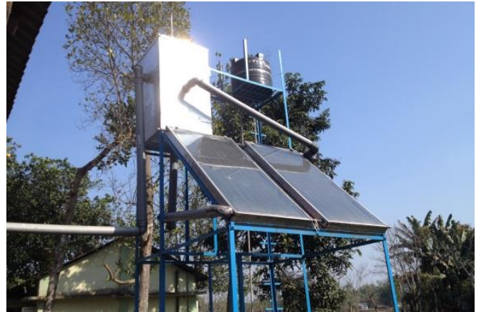
Photo 4: Installation solaire thermique pour la cuisine de Mogradangi
